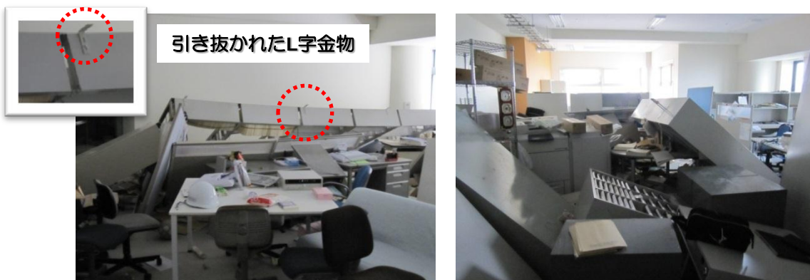
写真1 青葉山キャンパス総合研究棟12階にあった研究室の室内被害の事例（東日本大震災）※
