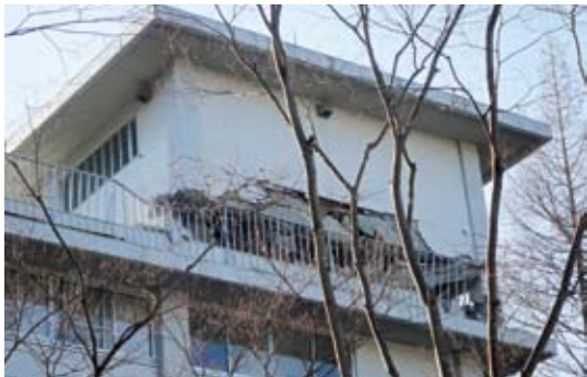
壁が剥がれ落ちた研究棟 (川内キャンパス)
