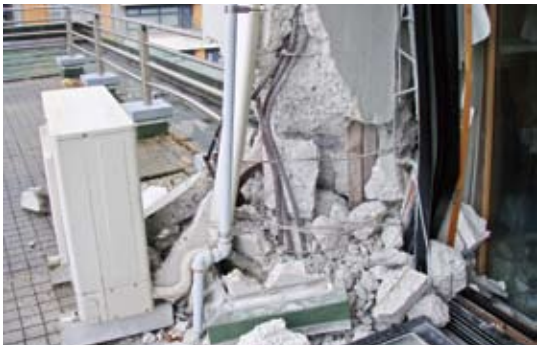
建物の1割に甚大な被災があった (青葉山キャンパス)
