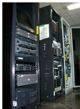
電気通信研究所のネットワークサーバー
